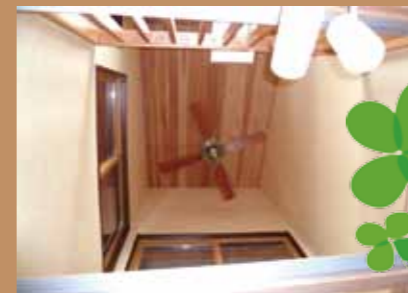
煙突効果があり換気ができる天窓が設けられた吹抜け
